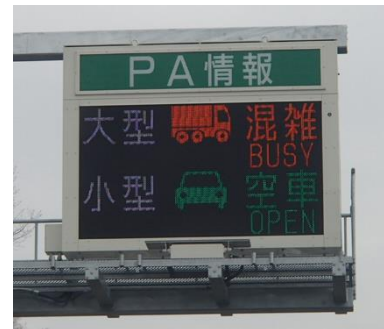
満車表示板の設置
