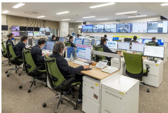
設備監視（大阪地区）
