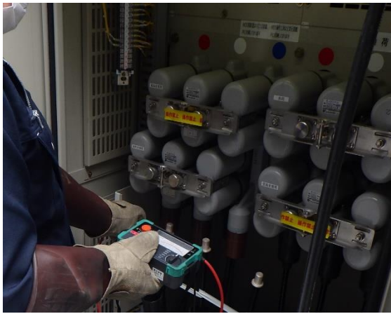
受配電設備点検
