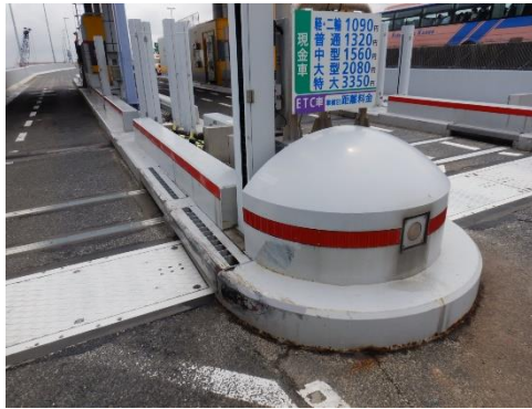
料金所アイランド損傷（補修前）
