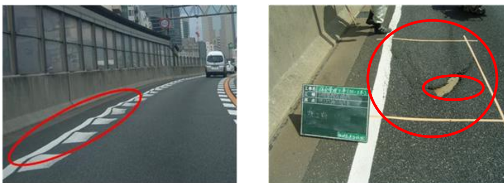
補修の必要な状態の事例
